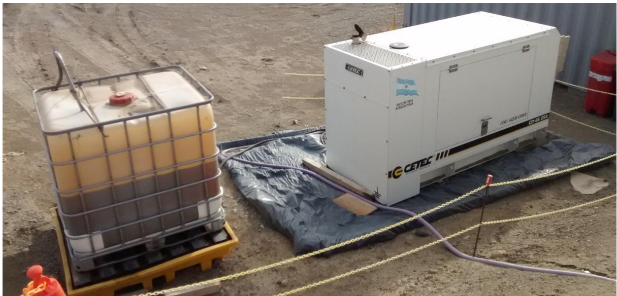
Figura 20. Generador eléctrico y tanque de alimentación (gas oil) en situación irregular, sobre contención secundaria insuficiente.
