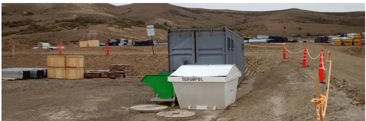
Figura 51. Acopio de tergopol en contenedor con tapa.
