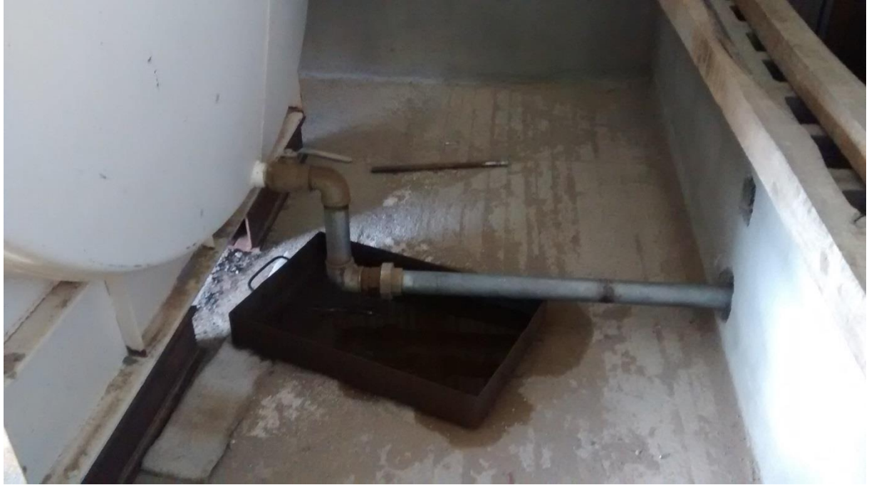
Figura 41. Detalle fugas y contención en cañería del tanque de gas oil
