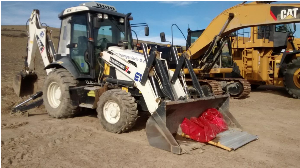
Figura 18. Bolsas rojas conteniendo suelos contaminados en zona de estacionamiento de equipos.
