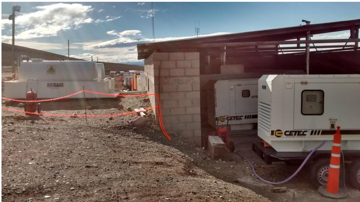
Figura 1. Tinglado de generadores eléctricos. Los tanques de combustible aéreos a la izq. aún no habilitados. A sotavento de la instalación se puede percibir olor a escapes en día ventoso.
