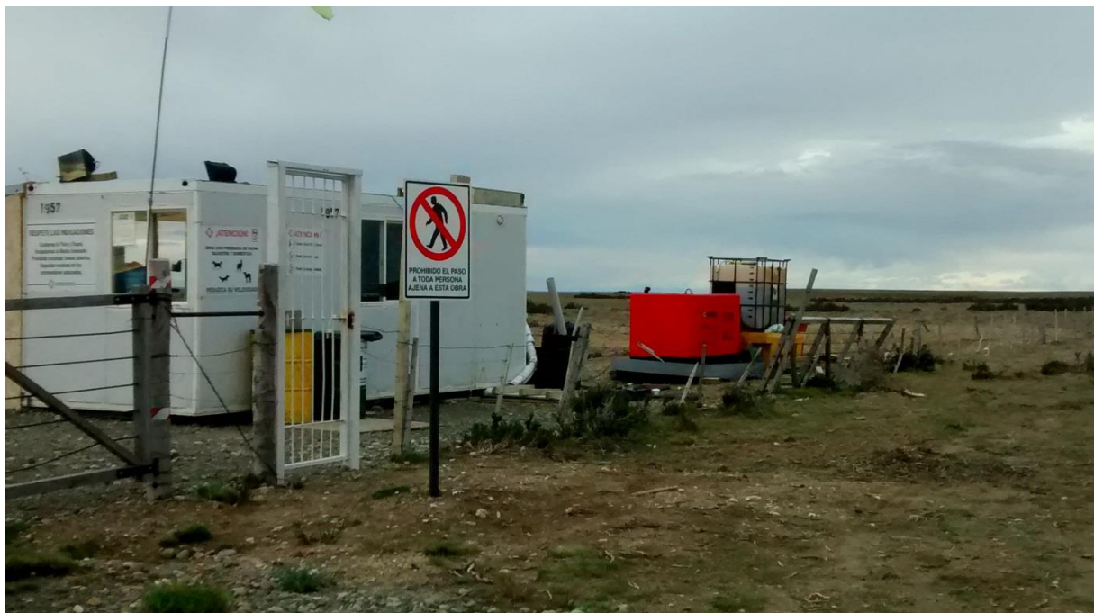
Figura 12. Garita de ingreso al campamento temporario NK. Se observa grupo eléctrico con tanque de suministro de gasoil adyacente, en condición irregular.
