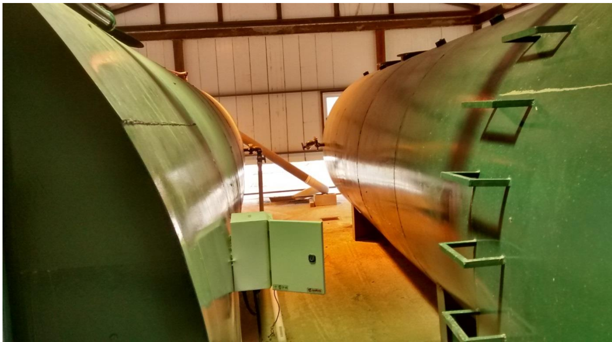
Figura 34. Tanques de tratamiento por lodos activados de la planta de tratamiento de efluentes cloacales, en el interior del galpón.
