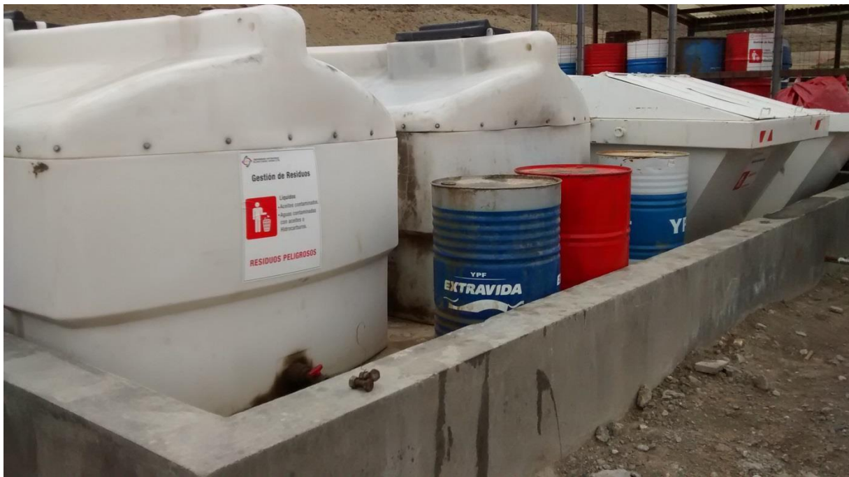
Figura 44. Contención secundaria en playa de acopio de residuos peligrosos, sector sin techar.
