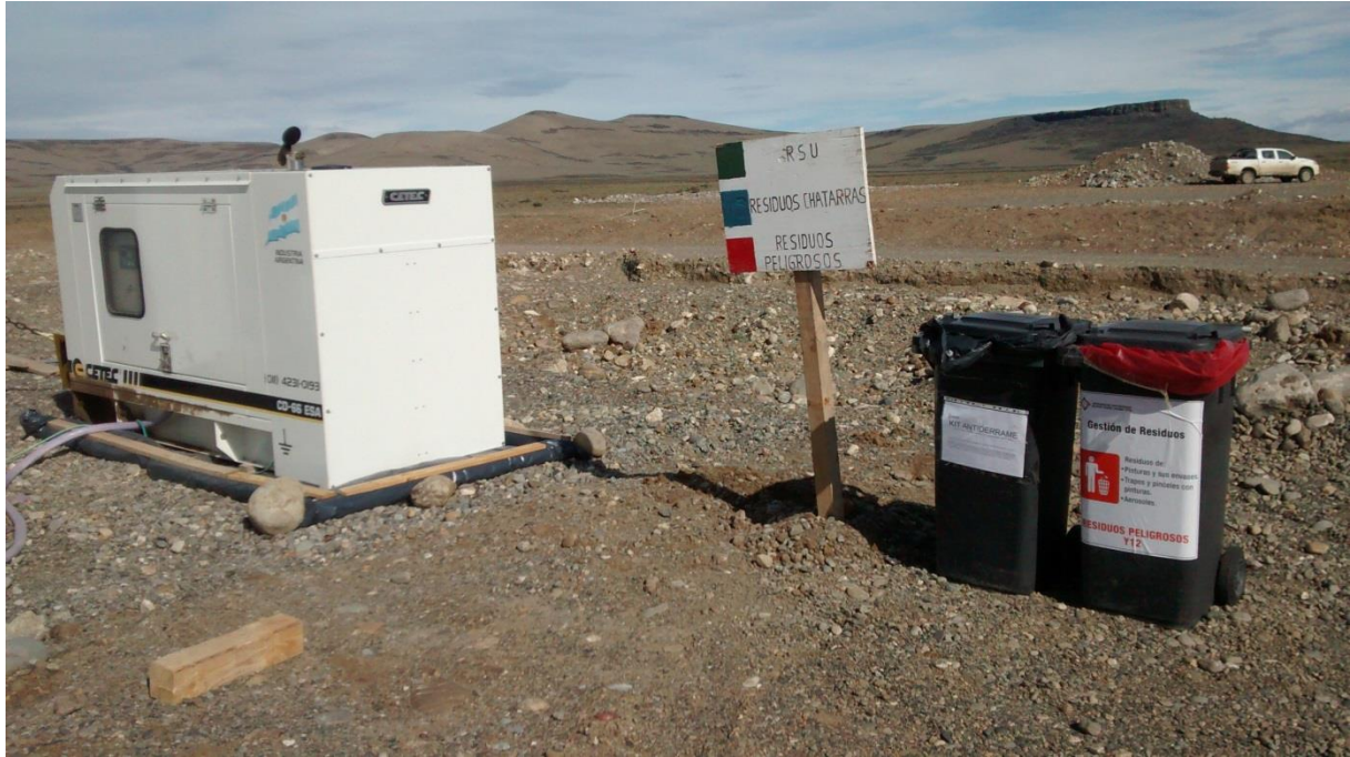
Figura 27. Generador eléctrico en playa de acopio de equipos, montado sobre una base de madera y agropol (insuficiente como sistema de contención secundaria), y recipientes para acopio de residuos y conteniendo kit anti derrames.
