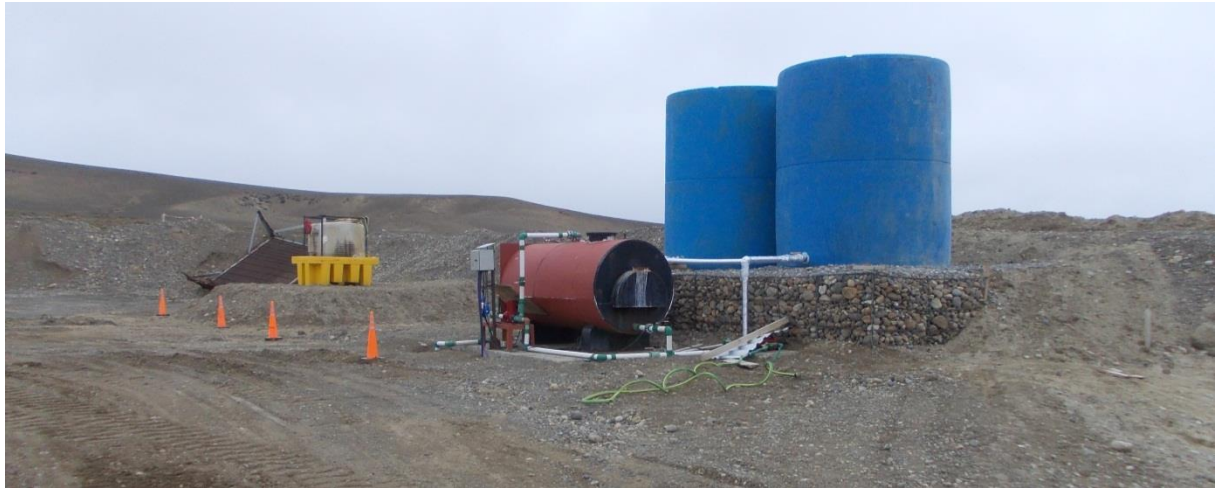
Figura 37. Planta de hormigón. Caldera, tanques de acopio de agua y tanque de acopio de combustible sobre contención secundaria.
