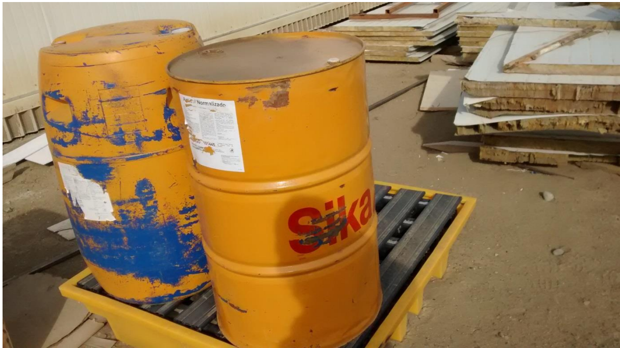
Figura 24. Detalle del sistema de contención secundaria de generalizado uso, con tambores de insumos de identificación posiblemente insuficiente.
