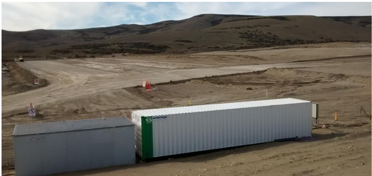
Figura 22. Vista de movimientos de suelos en área de futura residencia temporaria presa NK, conformando terrazas para el futuro emplazamiento de unidades habitacionales.
