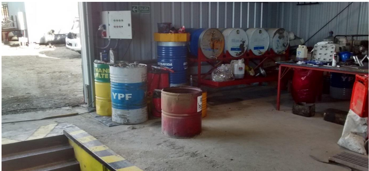
Figura 5. Taller de mantenimiento. Plataforma de tambores con grasas y aceites, con bandeja de contención adyacente a las bocas de expendio. Tambores sin contención secundaria. Bidón con líquido de pobre identificación.
