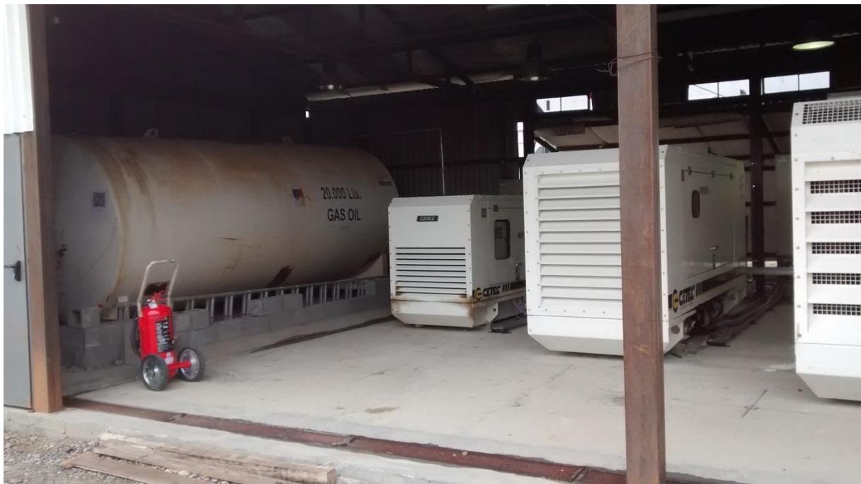
Figura 40. Recinto de grupos electrógenos. Tanque de acopio y suministro de gasoil a grupos electrógenos, no habilitado y sin contención secundaria. Capacidad 20 m3 (Nota: acopio observado en manguera de nivel aprox. 6,5 m3)
