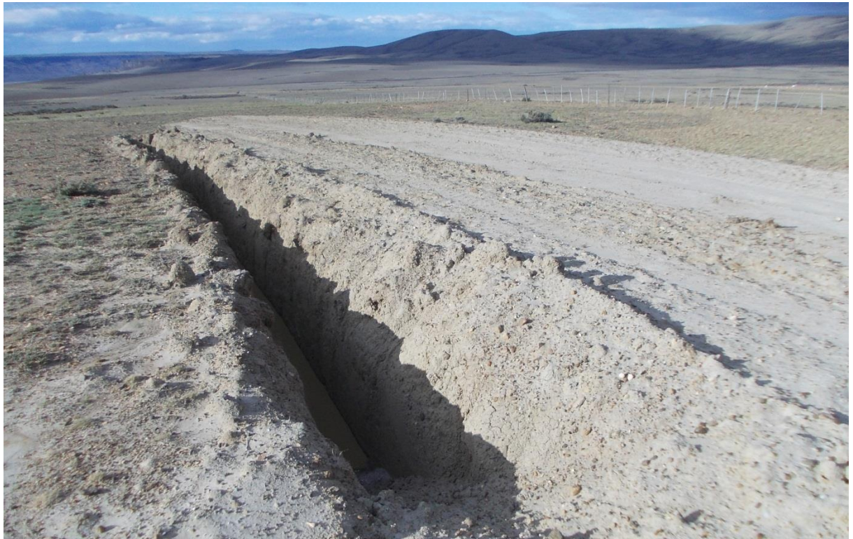
Figura 10. Cuneta con líquido aflorante en sector de lechos de infiltración de los efluentes tratados.
