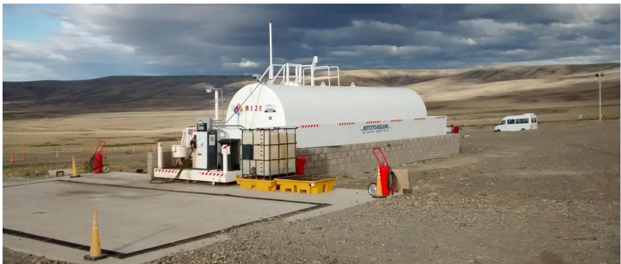
Figura 7. Instalación de expendio de combustibles (detalle). Se observan elementos de seguridad, señalización y prevención de contingencias, incluido un recipiente con un kit de control de derrames.
