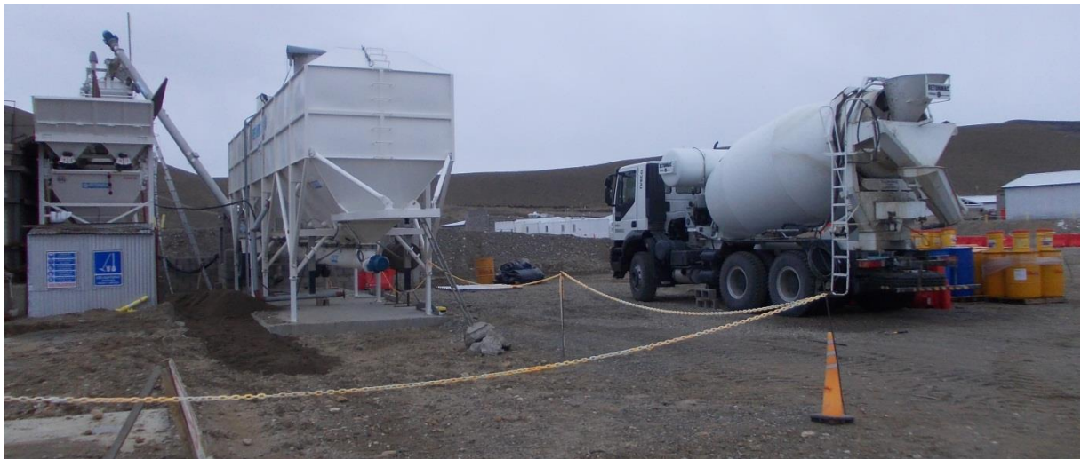
Figura 38. Planta de hormigón. A la derecha, acopio de aditivos del hormigón sobre pallets (sustancia biodegradable).
