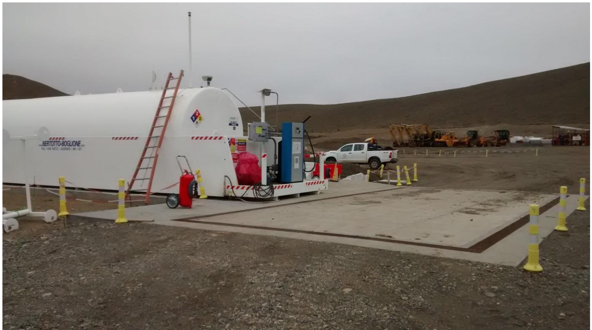
Figura 42. Instalación de despacho de combustibles.
