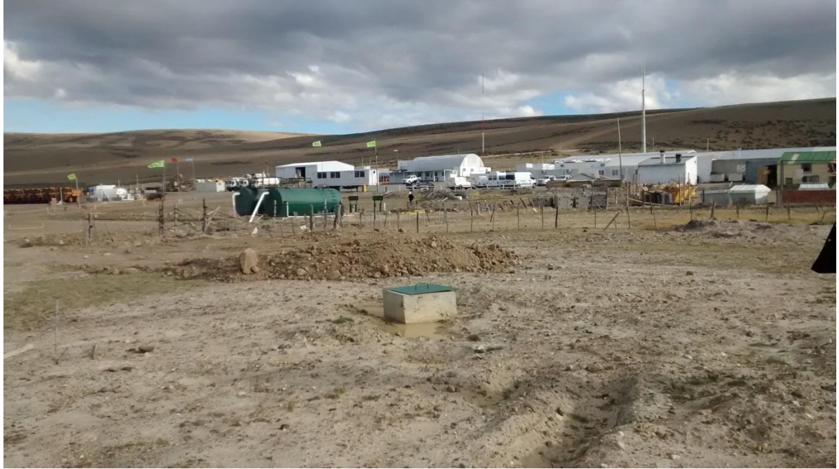
Figura 9. Sector de cámara de inspección previa a lechos de infiltración de los efluentes tratados.
