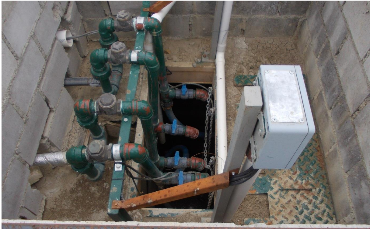
Figura 33. Cámara de equalización y bombeo de efluente cloacal crudo a la Planta de tratamiento.
